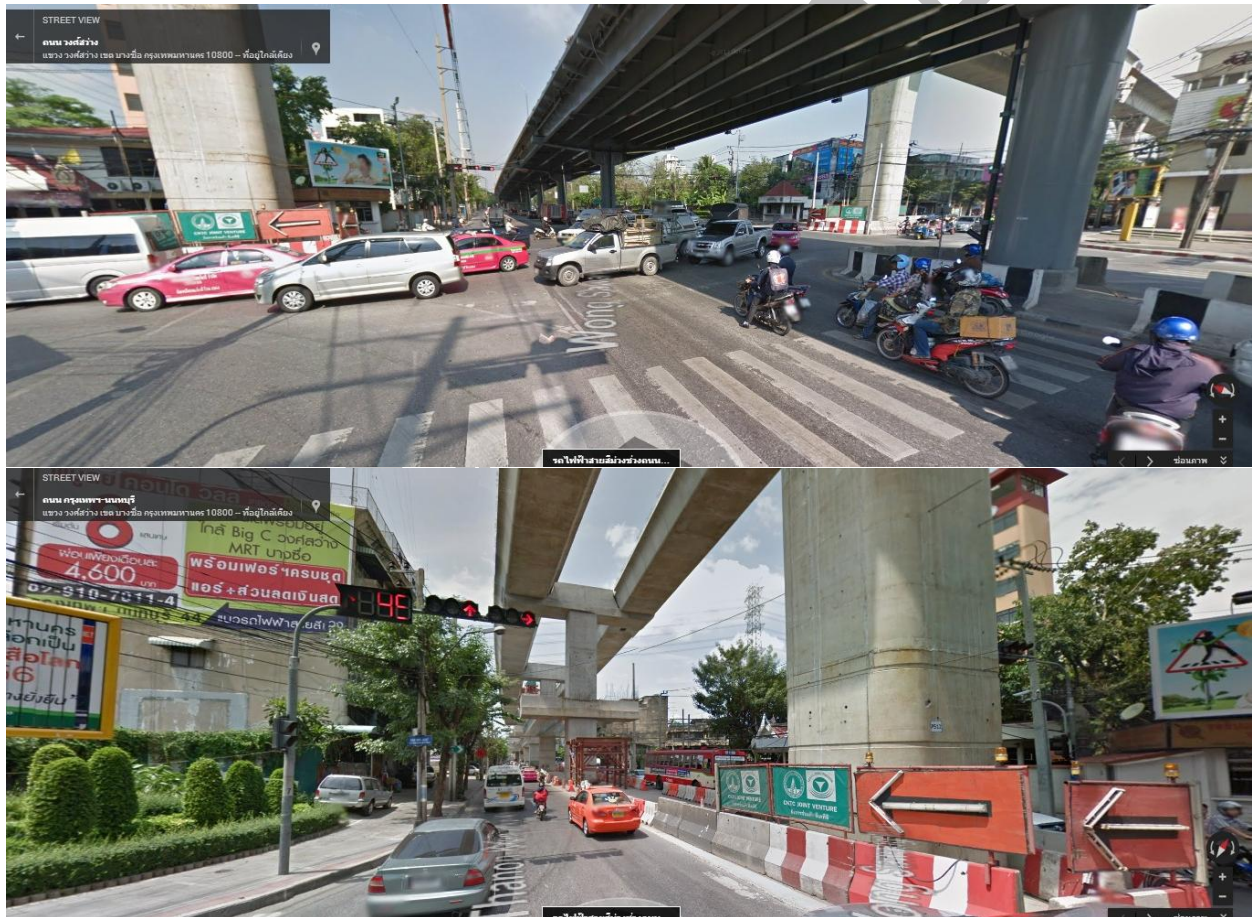
( ภาพ ๕.๑ แสดงสี่แยกวงศ์สว่างและการก่อสร้างสถานีรถไฟฟ้าบริเวณถนนกรุงเทพ-นนทบุรี )
